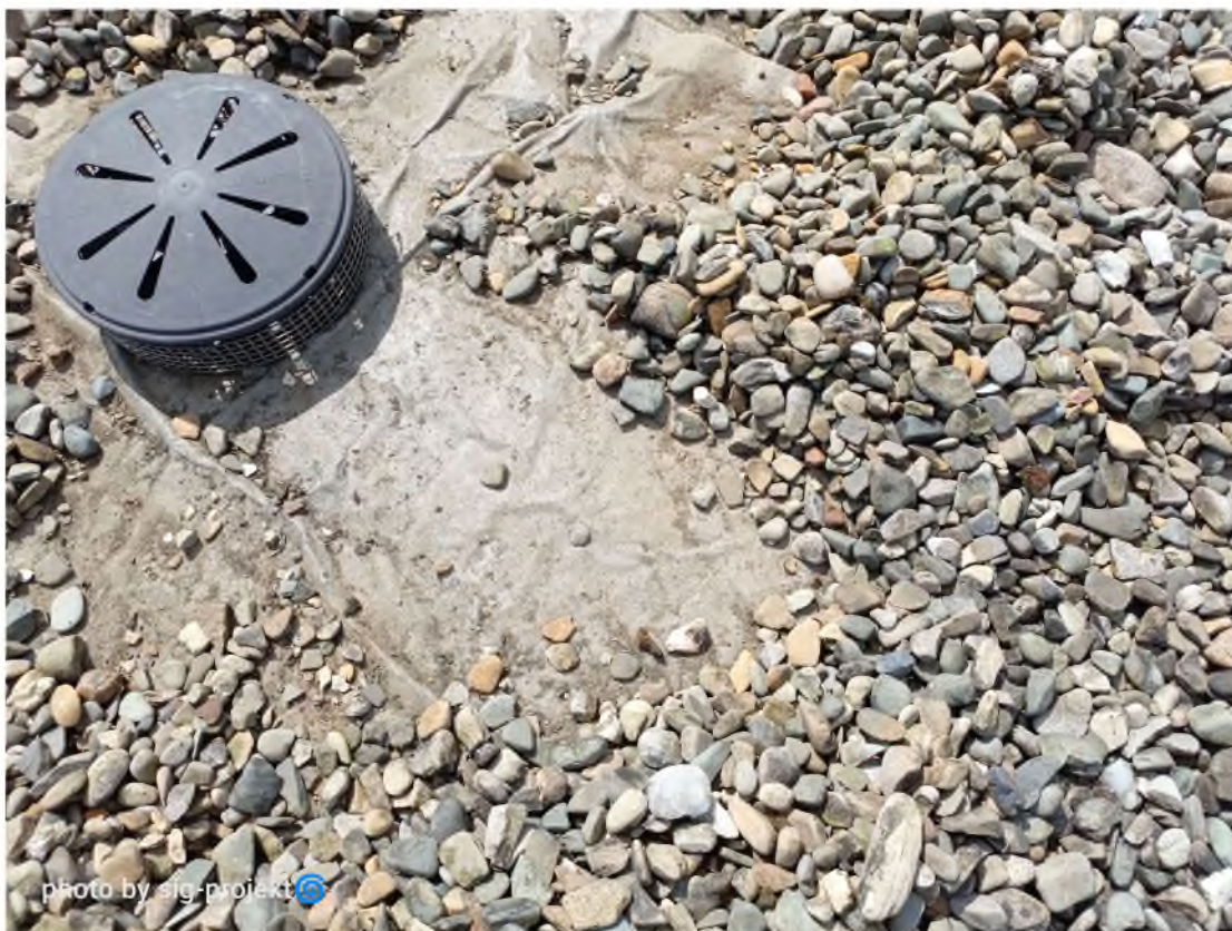
Zdj. nr 1 – po ściągnięciu balastu widoczne niecka wokół wpustu (2025)
