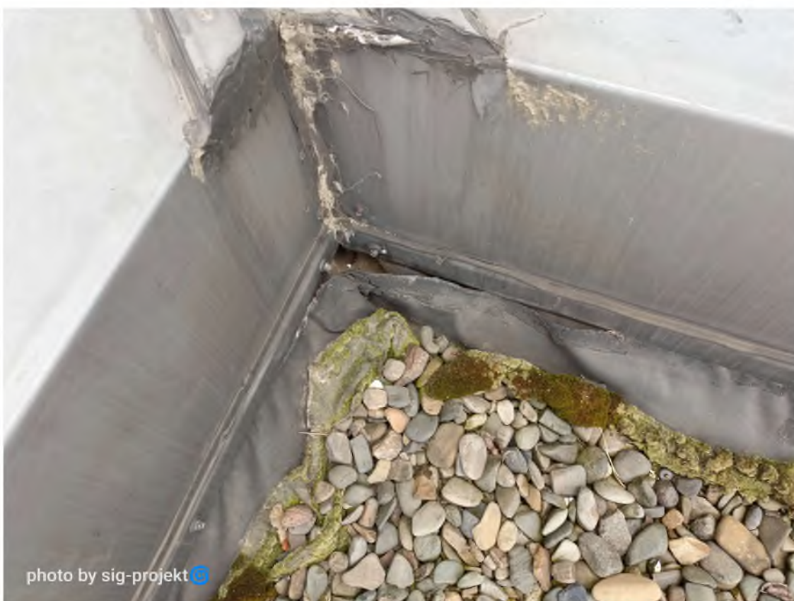
Zdj. nr 2 - odspojona membrana przy świetliku (2025)
