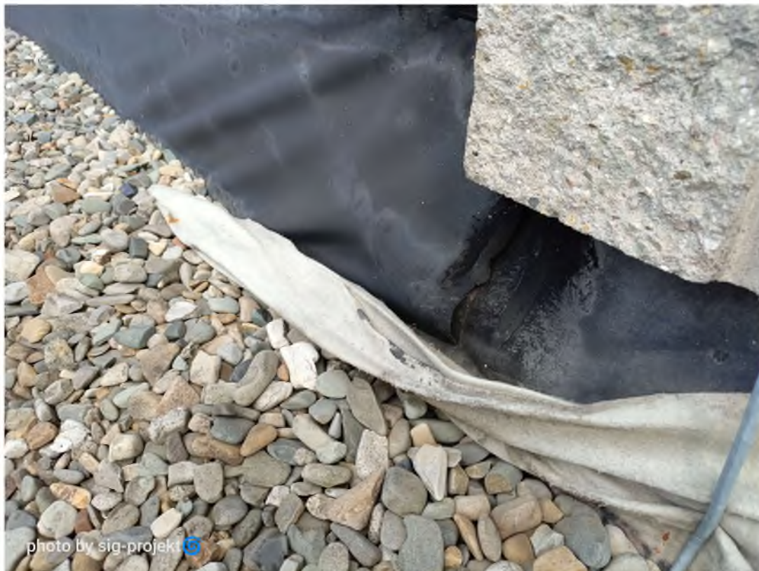
Zdj. nr 3 – kolejne uszkodzenia membrany na elementach pionowych (2025)
