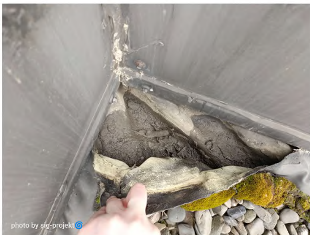
Zdj. nr 4 – naroże przy świetliku (2026)
