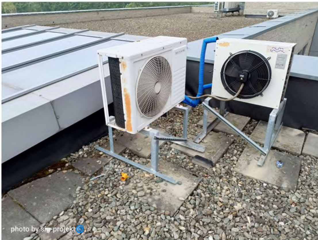
Zdj. nr 5 – klimatyzatory kotwione do płyt chodnikowych (2026)
